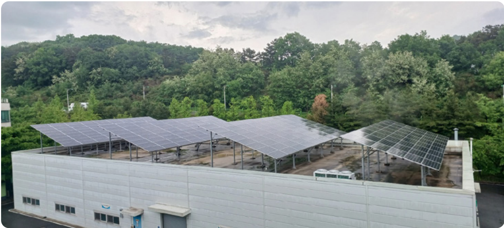
충주공장 태양광발전 설비
